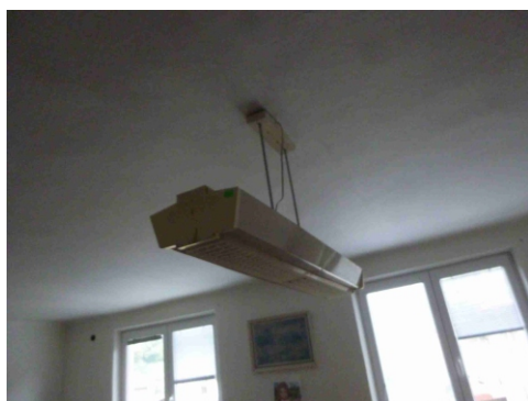
Obr.č.13 Prvky systému umelého osvetlenia
