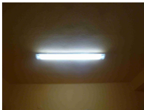
Obr.č.16 Prvky systému umelého osvetlenia
