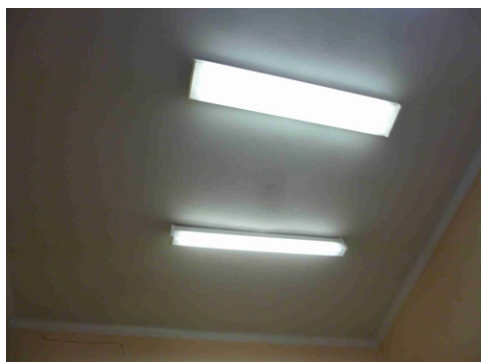
Obr.č.15 Prvky systému umelého osvetlenia
