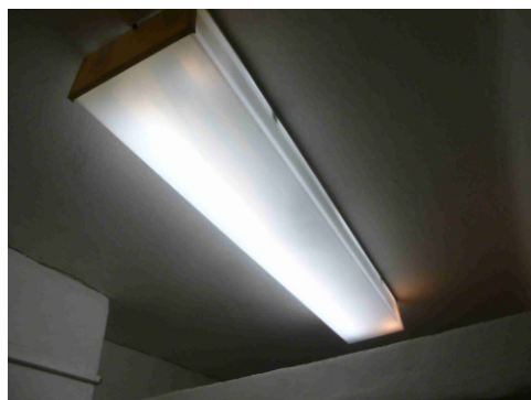
Obr.č.15 Prvky systému umelého osvetlenia
