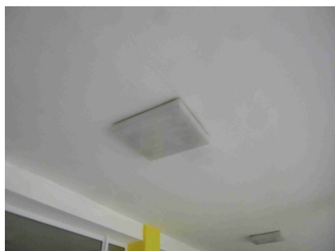
Obr.č.16 Prvky systému umelého osvetlenia
