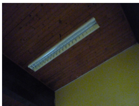
Obr.č.16 Prvky systému umelého osvetlenia
