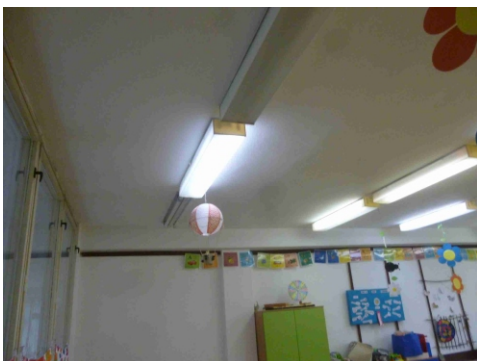
Obr.č.15 Prvky systému umelého osvetlenia
