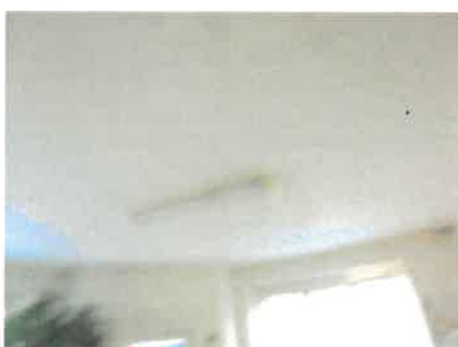
Obr.č.15 Prvky systému umelého osvetlenia
