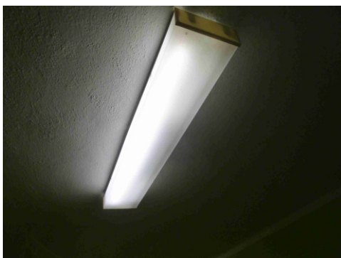
Obr.č.15 Prvky systému umelého osvetlenia
