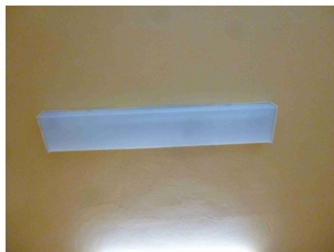
Obr.č.15 Prvky systému umelého osvetlenia
